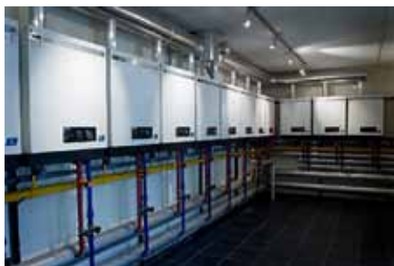
❖ Фото 1. Котельная на заводе-производителе Nefit (Голландия), состоящая из каскада конденсационных котлов первого поколения с теплообменниками из алюминиевого сплава, работает уже более 27 лет
